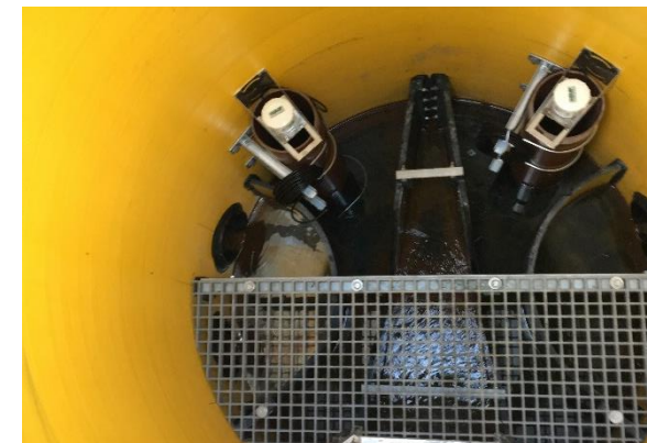
Ultraljudsgivare för mätning i pegelbrunn
