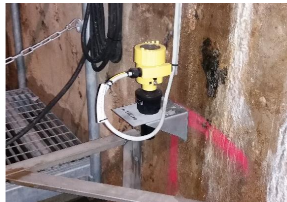
Ultraljudsgivare för styrning av dränagepump
